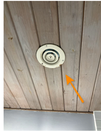
Vent fan inoperable
